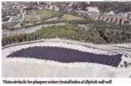
Vista aèria de les plaques solars instal·lades al dipòsit salí de Súria
